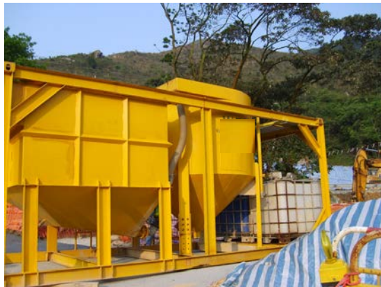
有定期保養污水處理設備
