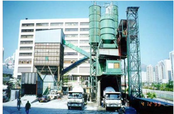
混凝土配料廠
