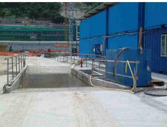
車輪沖洗設施，洗滌槽和槽保留水洗砂/塵
