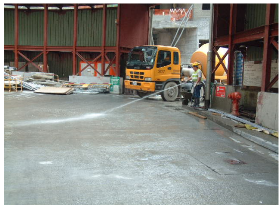
不提供洗車輪洗滌槽和槽。污水可以進入雨水渠直接造成堵塞
