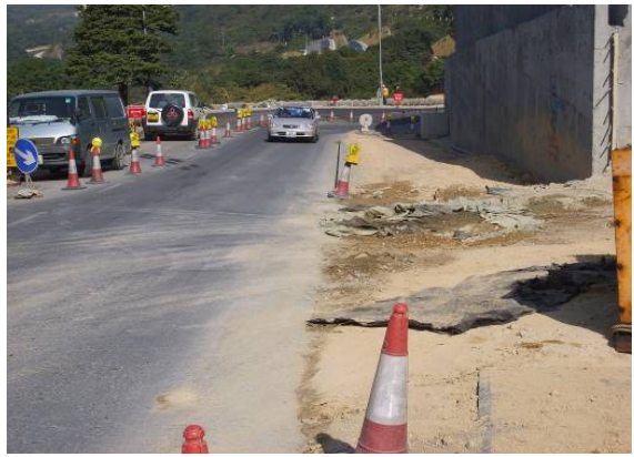
在工地出口沒有提供清洗設施造成土壤和灰塵沉積在公共道路
