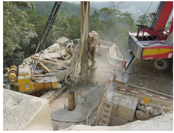
在鑽探工程期間沒有噴水和使用覆蓋布，造成塵埃排放
