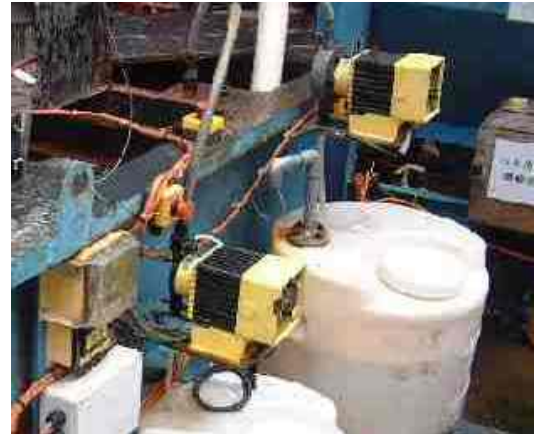
沒有適當的保養污水處理設備
