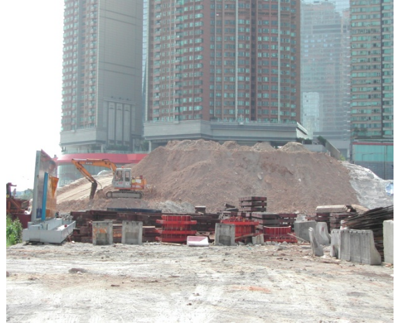
塵土飛揚的堆存物料沒有覆蓋，導致潛在的塵埃排放
