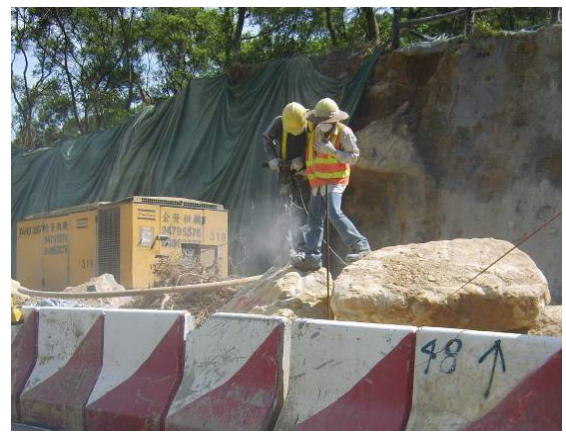
沒有在破碎工程期間噴水，造成局部的塵埃排放
