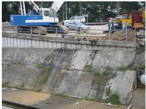
臨時排水通道沒有建成，導致排放未經處理的廢水
