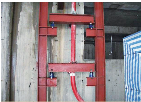
混凝土輸送管的吸音裝置
